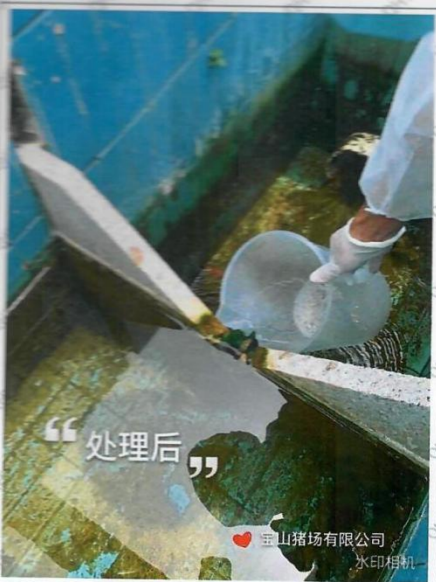
综合废水处理后排出口
