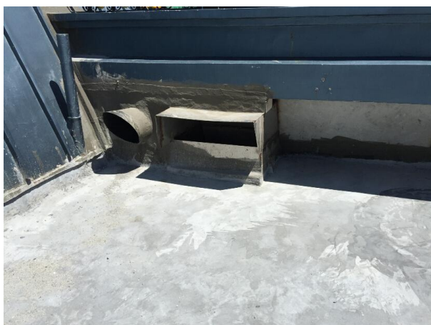
锅炉排烟口和发电机房排烟口
