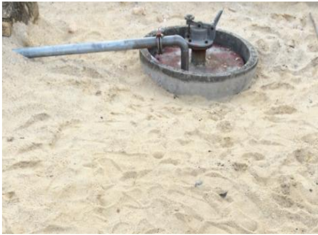
照片 4 消防沙池
