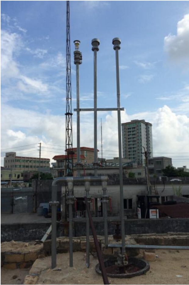
照片 7 油罐卸压阀
