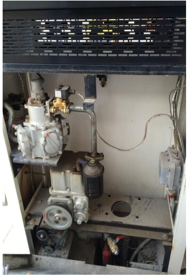
照片 8 独立油气回收泵
