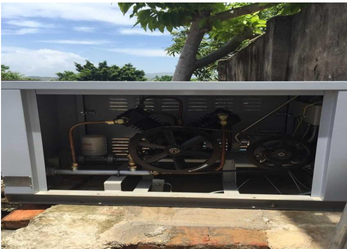
照片 5 油气回收泵内部管路
