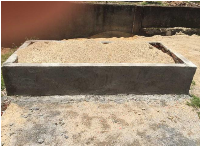
照片 4 消防沙池
