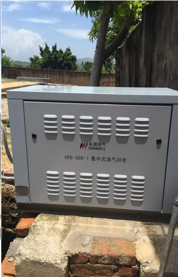
照片 9 集中式油气回收泵
