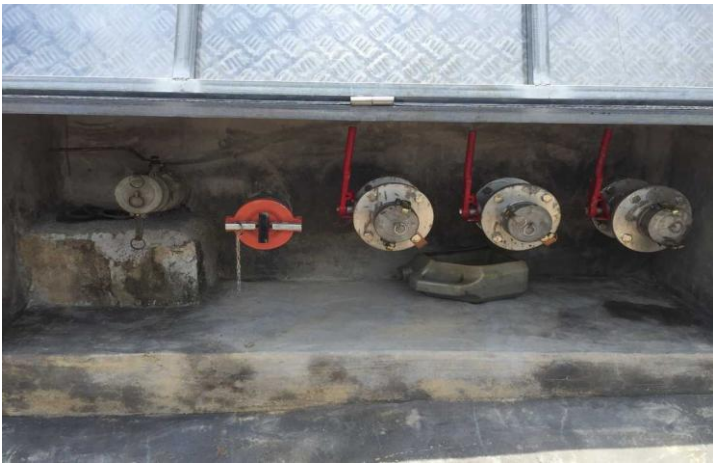
照片 8 油罐油气回收口
