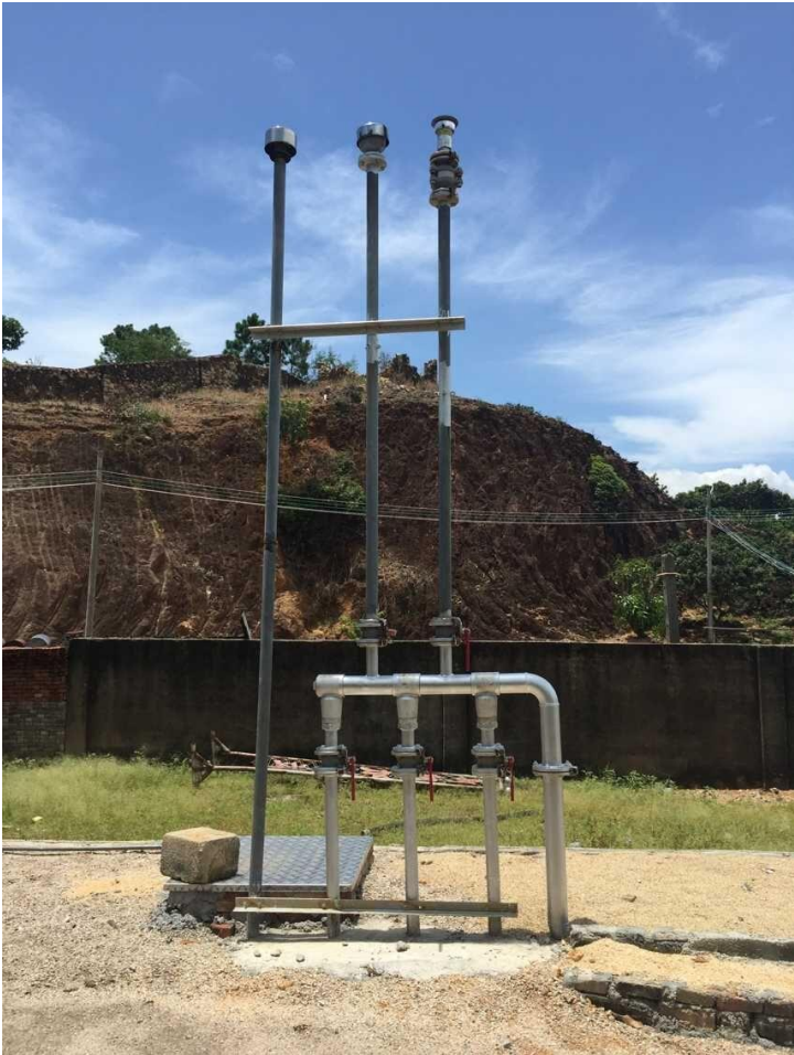
照片 7 油罐卸压阀
