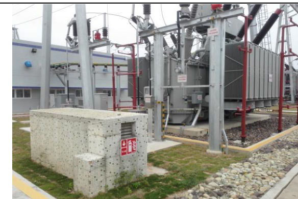
主变及消防设备
