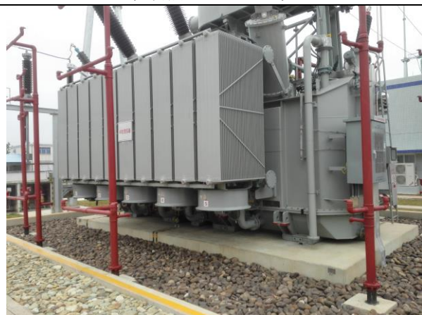
#3 主变（本期扩建主变）
