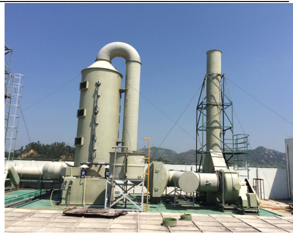
照片 8 碱性废气排放口
