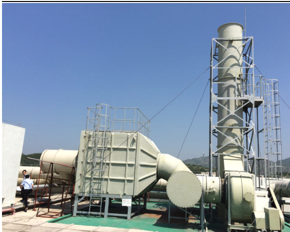
照片 7 有机废气排放口 (合用)
