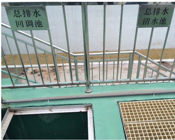
照片 3 总排水回调池与清水池
