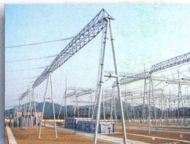
500千伏茅湖变电站一角
