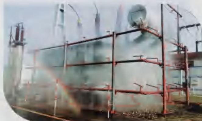
2020年4月15日，汕尾供电局为设备“接风洗尘”，排查隐患，利用变压器消防自动水喷雾喷淋系统的特有功能给#2主变本体清洗
