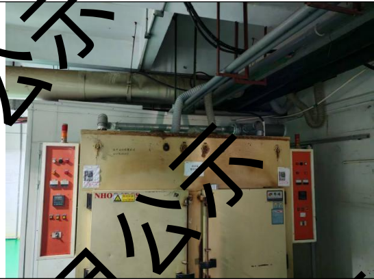
烤箱废气收集方式
