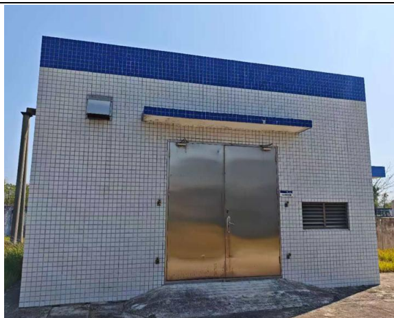
110kV 接地变室
