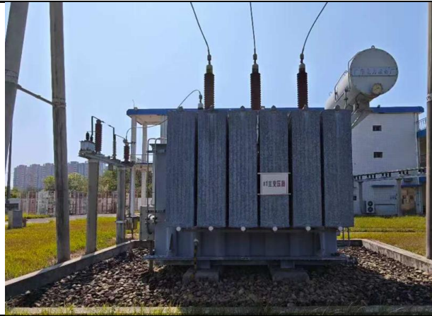
#1 主变及储油坑
