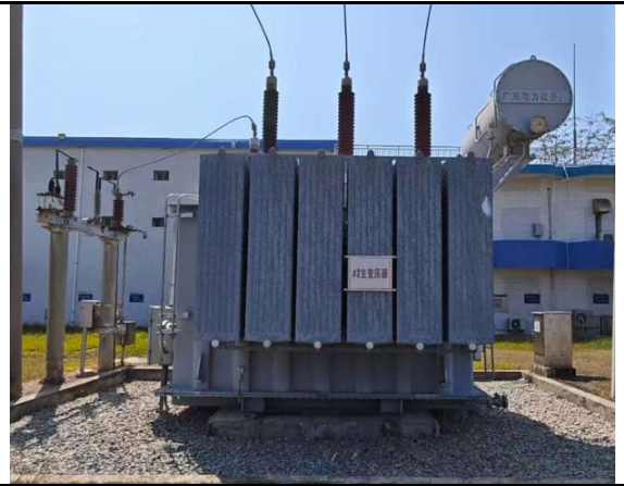
#2 主变及储油坑
