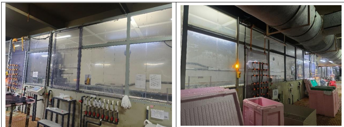
现有浸泡线废气收集方式（车间密闭收集）
