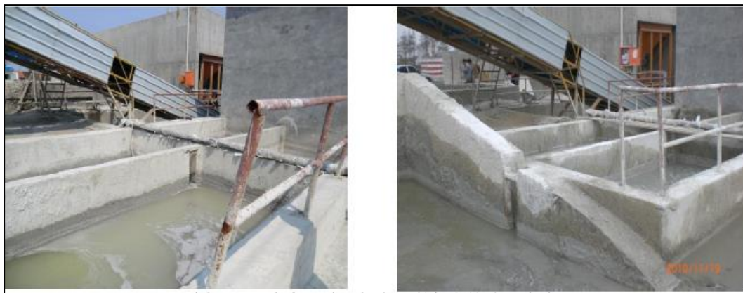
图 5.2-1 崇启通道 I 标水泥混凝土拌站沉淀池
