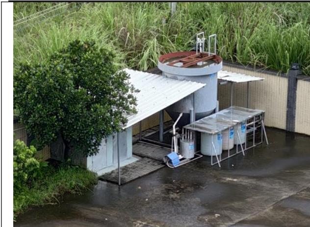
项目厂区内废水处理站
