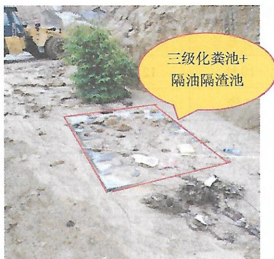
照片 4.1-1 三级化粪池+隔油隔渣池
