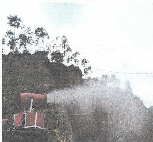
照片 4.1-3 水喷淋装置
