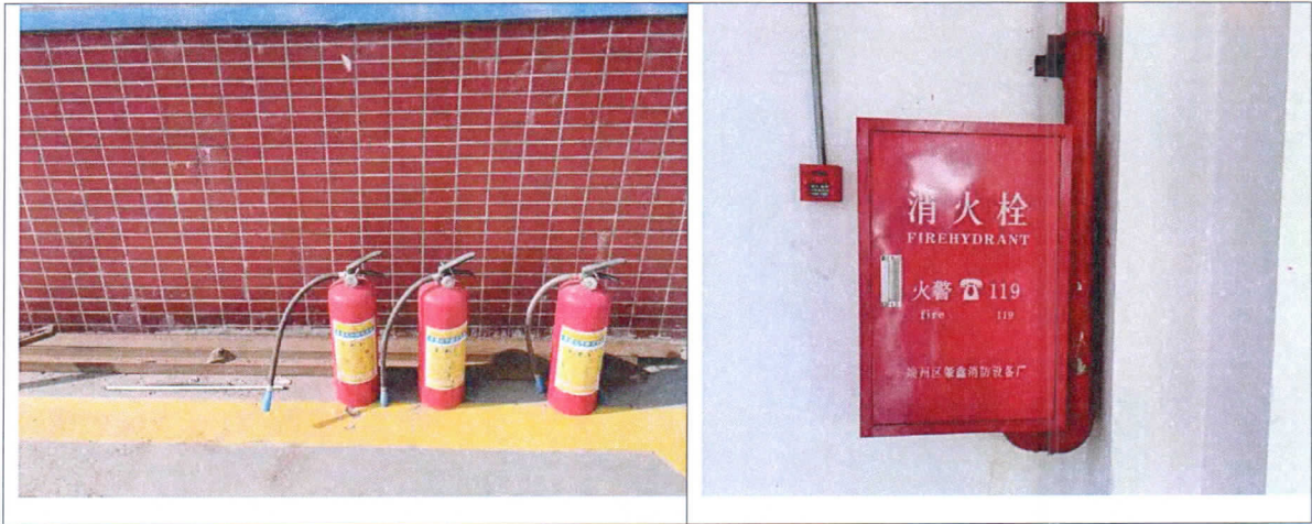
图 4.2-3 厂内消防设施实景图
