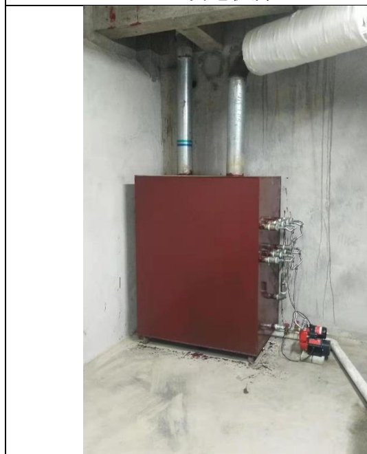
备用发电机处理设施
